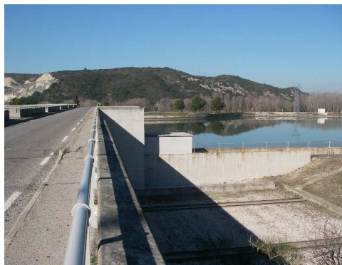
Local dans lequel est installée la balise aquatique
